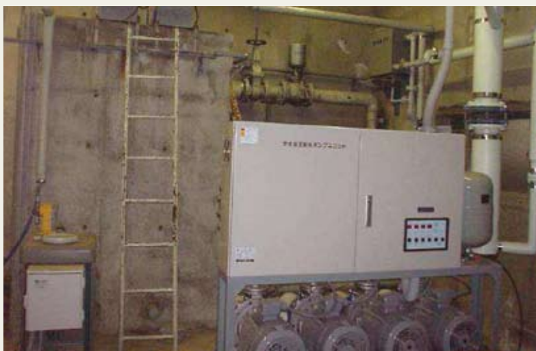
水再利用設備（中水設備）
