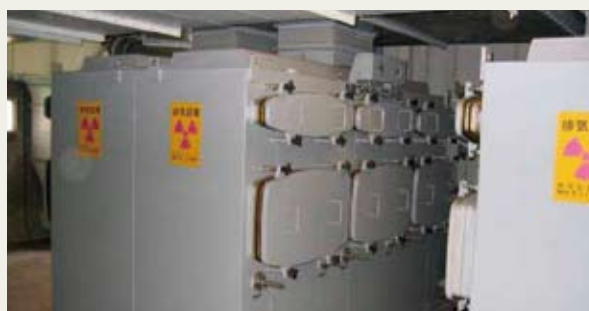
RI施設排気施設
