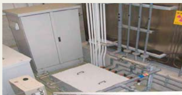
RI施設排水設備
